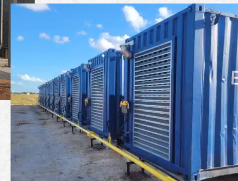
gas de poço
